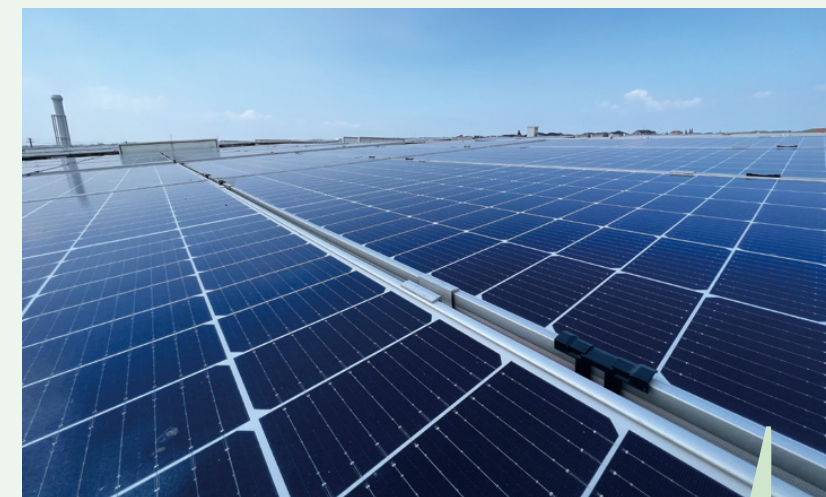
▲ 大家投控投资分布式光伏项目现场
